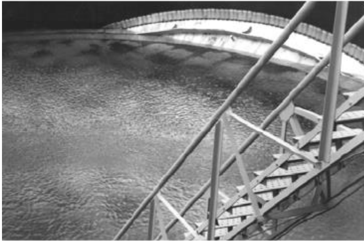
Yağmur suyunun tahliye edilememesinden dolayı oluşan yüzer tavan batmasına bir örnek
